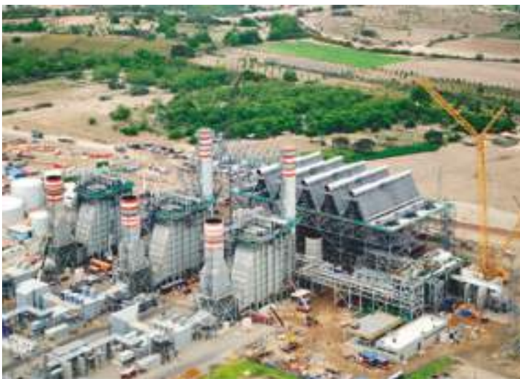
© Kallpa Generación S.A.
